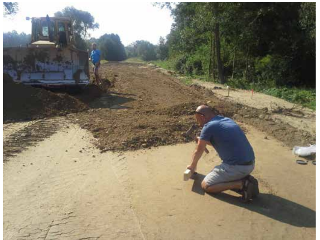
FOTO: z výstavby hráze, u vegetačních úprav jsou připravována místa pro náhradní výsadbu nových dřevin, archiv Povodí Odry
